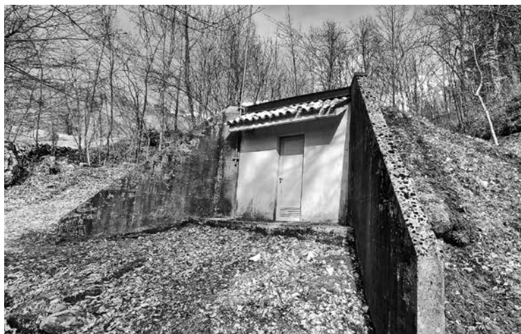
LETOS NAČRTUJETA OBČINA KOBARID IN KOMUNALA TOLMIN VGRADNJO UV-SVETILK na vodohranih Idrsko, Smast-Ladra in Vrsno, vodohrana v naseljih Drežnica in Smast pa opremijo z električno energijo. Foto: Jernej Bric
