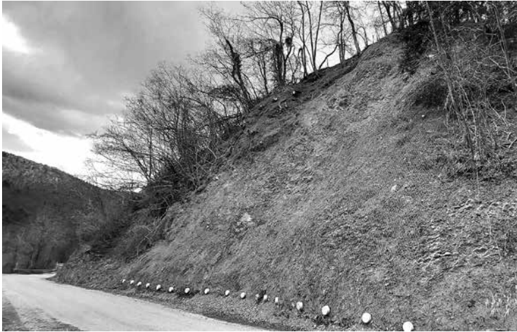
LOKALNO CESTO LIBUŠNJE-VRSNO je januarja zasula večja količina zemlje, kamenja in drevja. Po odstranitvi materiala so zaradi varnosti postavili zaščitno mrežo. Foto: Jernej Bric
